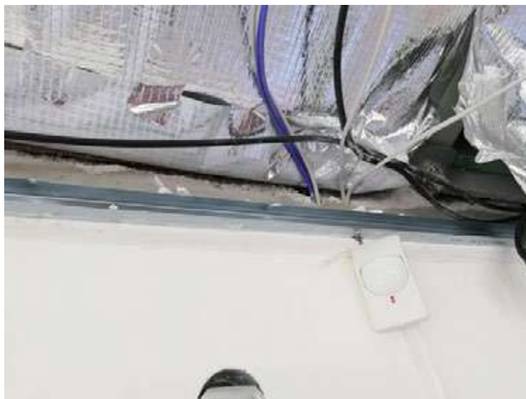
Obrázok 2: Pôvodná parotesná zábrana, ktorá nebola vzduchotesne napojená na obvodové konštrukcie
