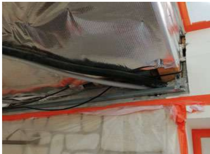
Obrázok 3: Pôvodná parotesná zábrana v bazénovom priestore. Celkovo absentujúca vzduchotesnosť
