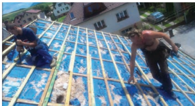
Rozpadnutie podstrešnej fólie pod plechovou krytinou po 4 rokoch od realizácie
