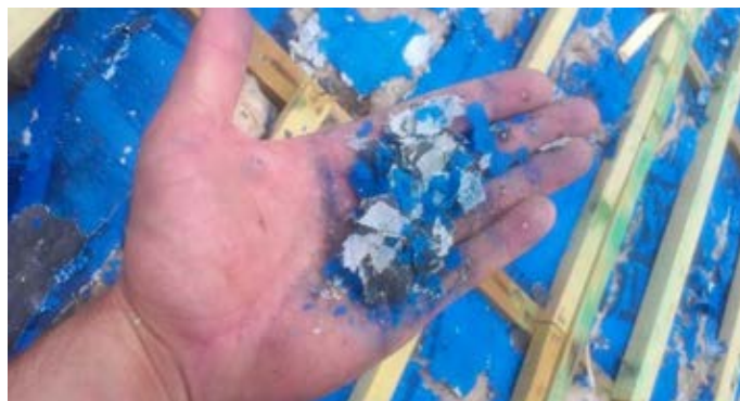
Totálna degradácia podstrešnej fólie. Fólia nebola UV stabilizovaná, ani tepelne stabilizovaná
