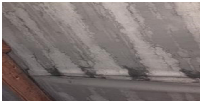
Zatečená fólia pod plechom po 5 rokoch od realizácie
