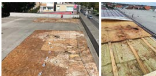
Obr. 1 Použitie OSB dosky ako podklad pod povlakovú krytinu a jej degradácia spôsobená kondenzáciou na spodnom povrchu [1]
