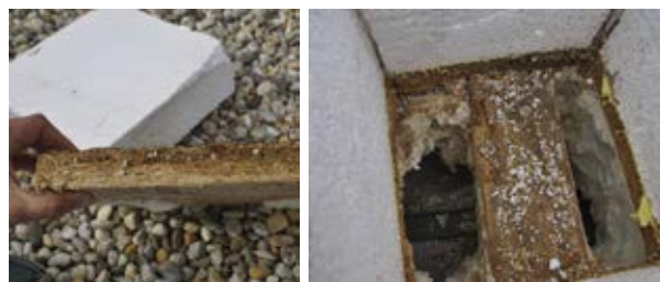
Obr. 3 Použitie OSB dosky ako debnenie a nosný podklad pod parozábranu pri kombinácii tepelnej izolácie nad aj pod parozábranou – hniloba na OSB doske a takisto na hornej strane stropnice
